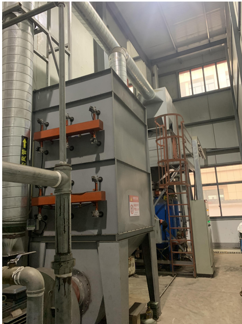
图4-3 喷砂废气处理设施图
